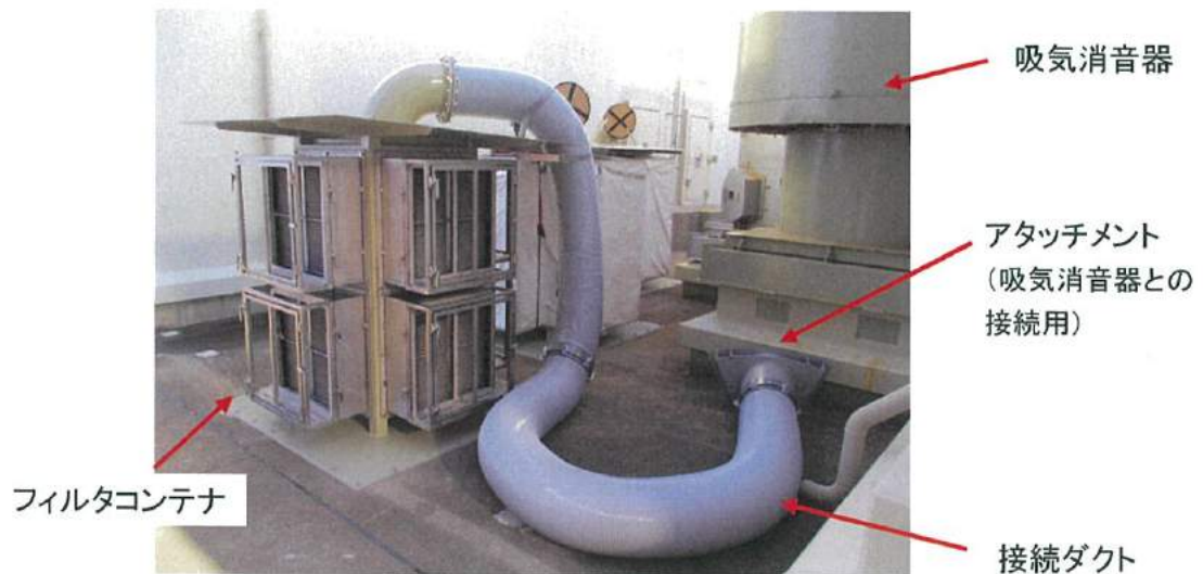
図1 非常用ディーゼル発電機フィルタコンテナ
